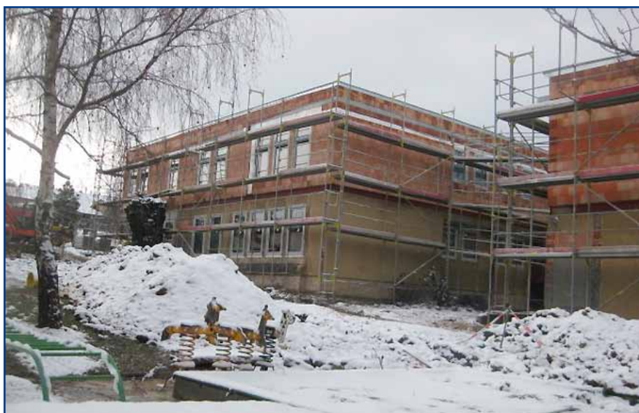
Úplně největší investiční akcí letošního roku je rekonstrukce a dostavba mateřské školky ve Větrné ulici, která by měla být ukončena v dubnu
