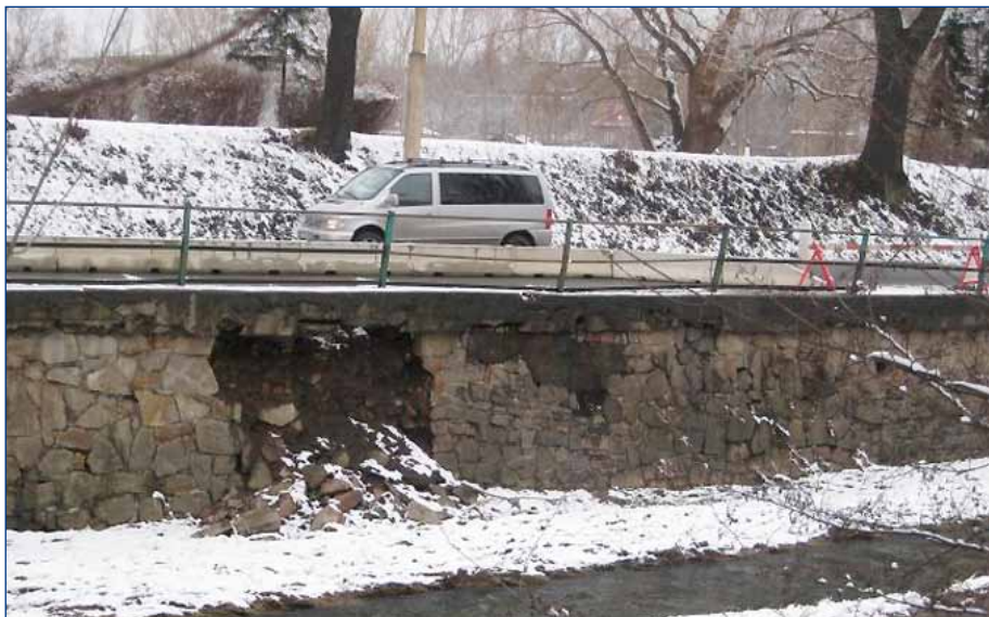
Nad poškozeným břehem Červeného potoka se auta vyhýbají v dostatečné vzdálenosti vyznačené betonovými zábranami.
